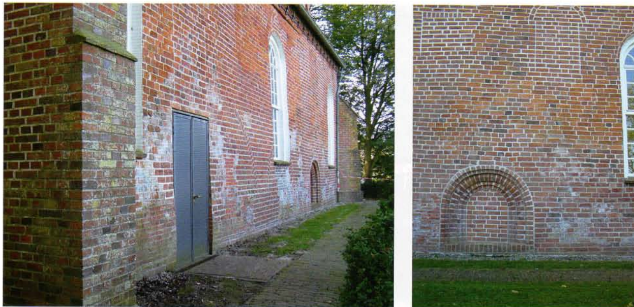
Abb. 9 Nordseite des Langhauses, mit dem zugesetzten ehemaligen Nordportal unter einem gotischen Fenster (Foto: A. Prussat, Ostfriesische Landschaft).
